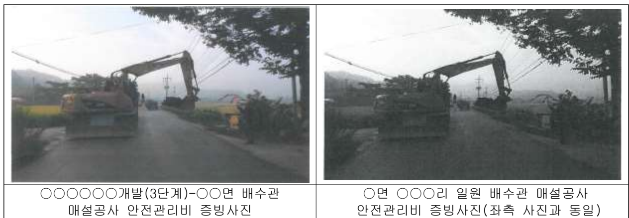
[사진2] 안전관리비 구매 증빙사진(타 사업현장 사진 제출을 통한 부당 청구)
