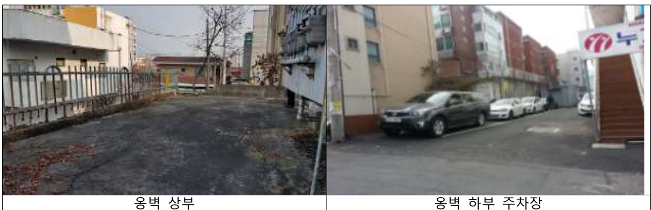
[사진2] 용벽 상·하부 관리 현황
