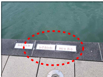
수심표시안내판 설치 부적정 〈난지물놀이장〉
