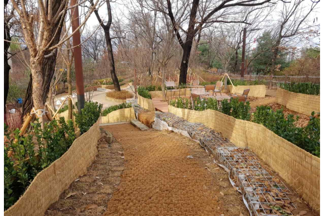
▲ 개비온 옹벽 현황(설계 32m→ 실제 21m, 감 11m)
