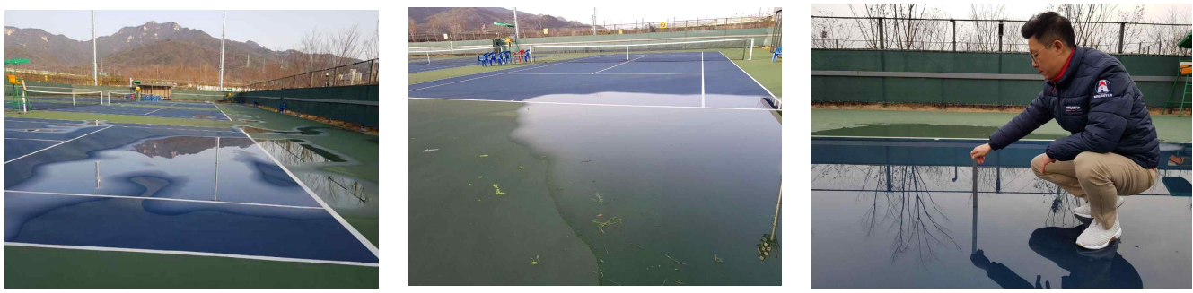
▲ 테니스 코트 평탄성 불량으로 강우시 자연배수되지 않고 물고임 발생 ▲ 물고임 깊이 최고 7mm (물품납품자 측정)
