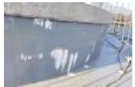
▲ 벽체 균열 및 백태현상 (벽체 등 29개소)
