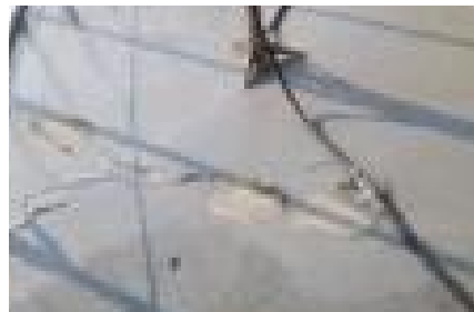
▲ 바닥 방수층 균열 및 벗겨짐 (바닥 약 10개소)
